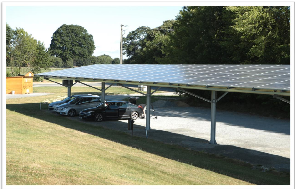
Figure 6 : Exemple d'ombrières installées sur un parking
