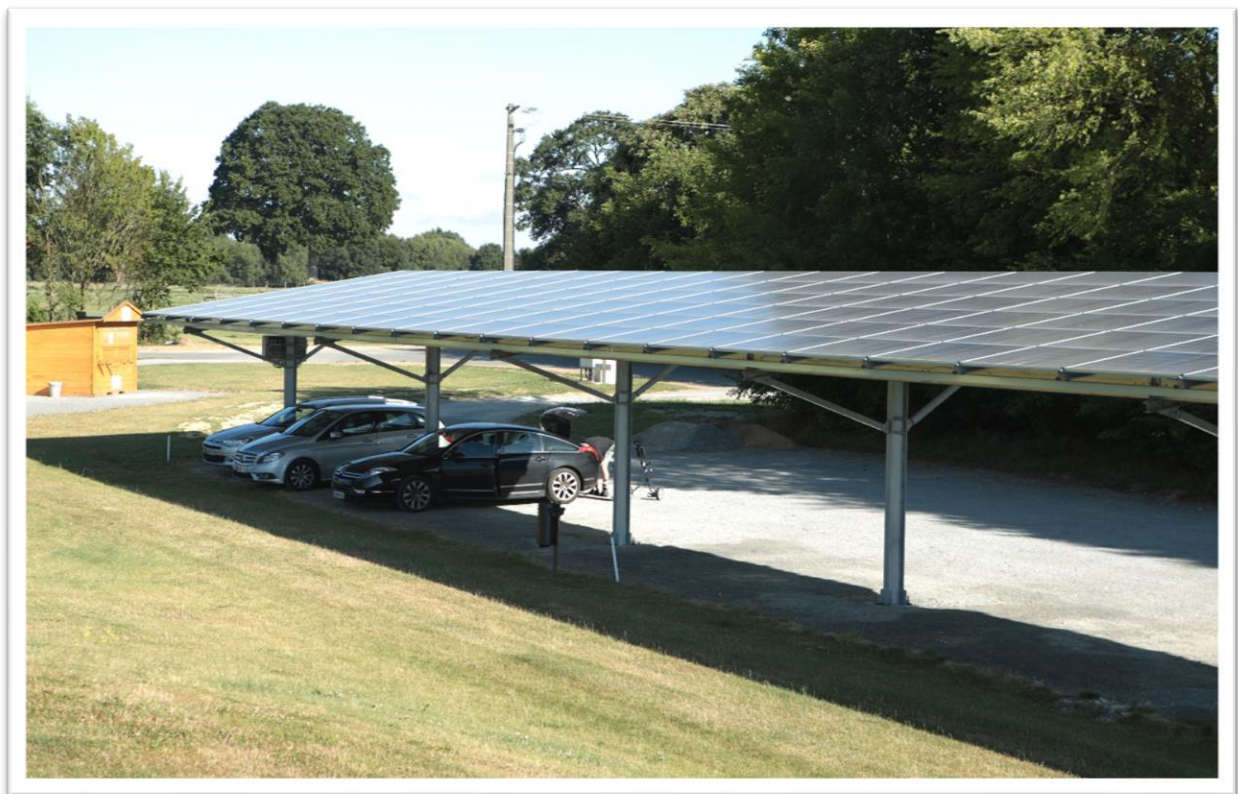
Figure 6 : Exemple d'ombrière installée sur un parking.
